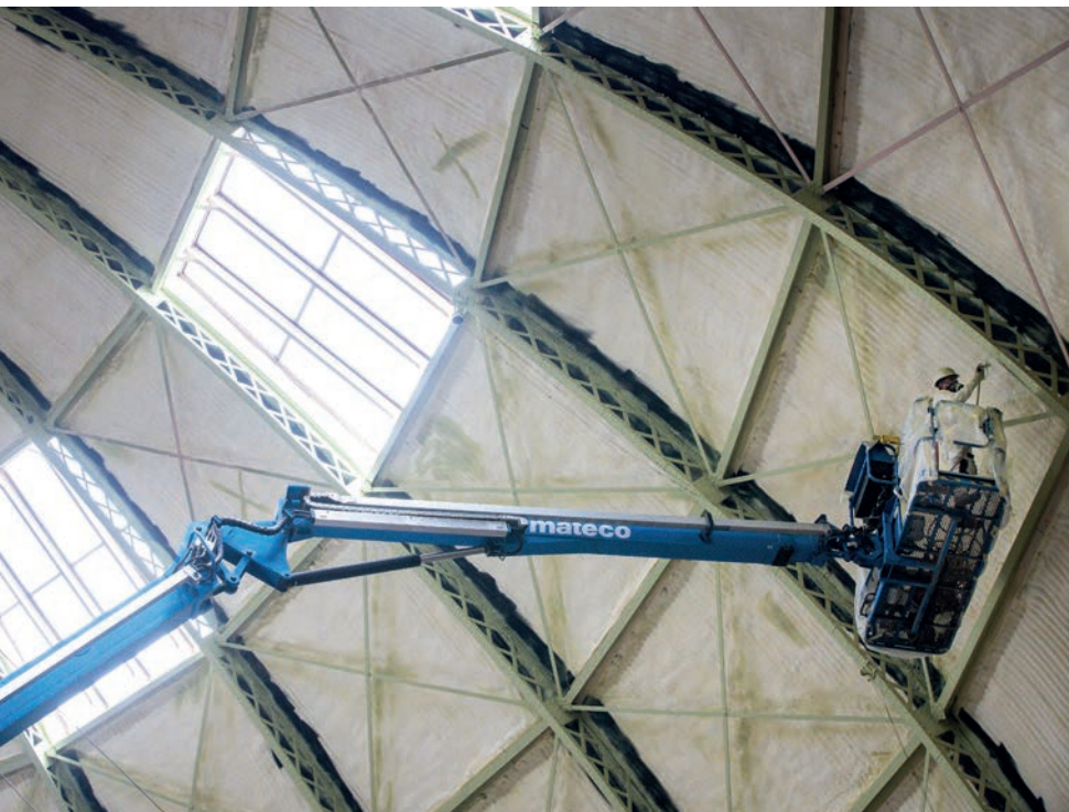
Twee schilders werkten zo'n 3,5 week op hoogte aan de verfapplicatie van het staalwerk
